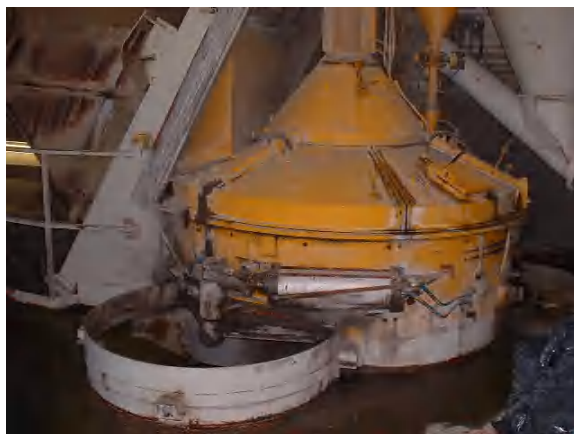
Pvingunarblandari í steypustöð
